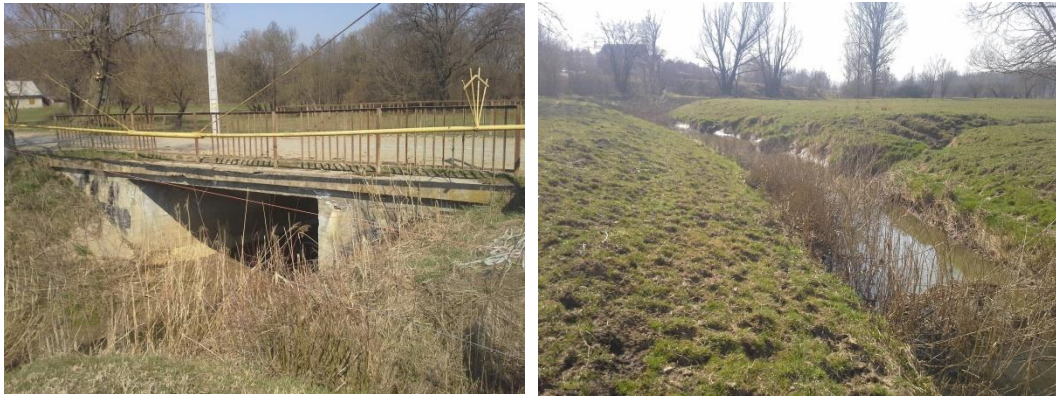
Kossuth Lajos utca Tókaji parkerdő felé vezető bekötő út hídja és a híd alatti vízfolyásszakasz
